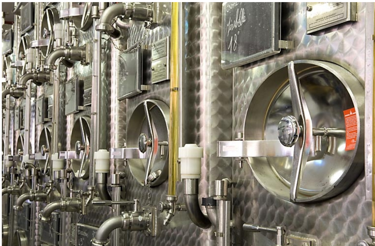
Chai. Détail des cuves.
