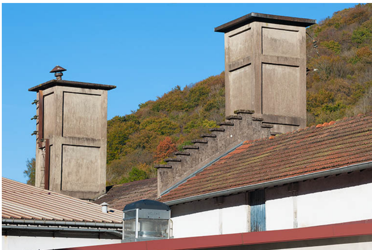
Anciens transformateurs électriques.
