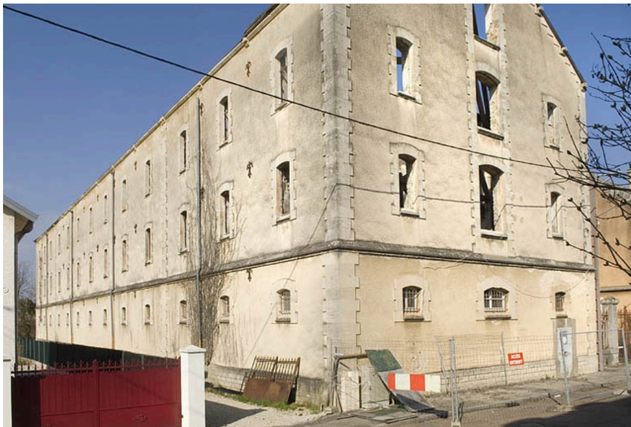
Aile ouest incendiée vue de trois quarts.
