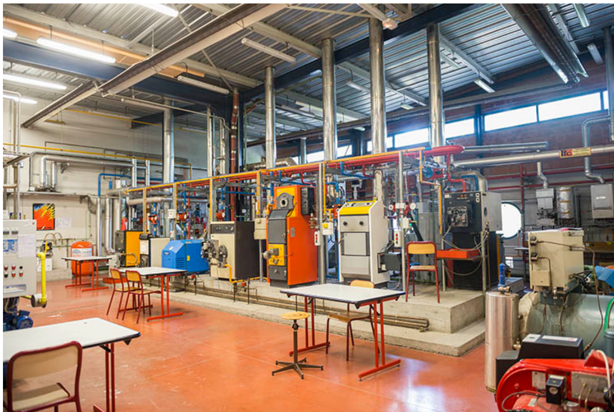
Vue intérieure des ateliers du pôle énergie.
