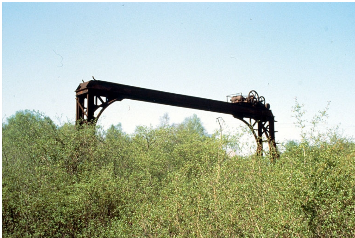
Forge Neuve. Portique roulant.
