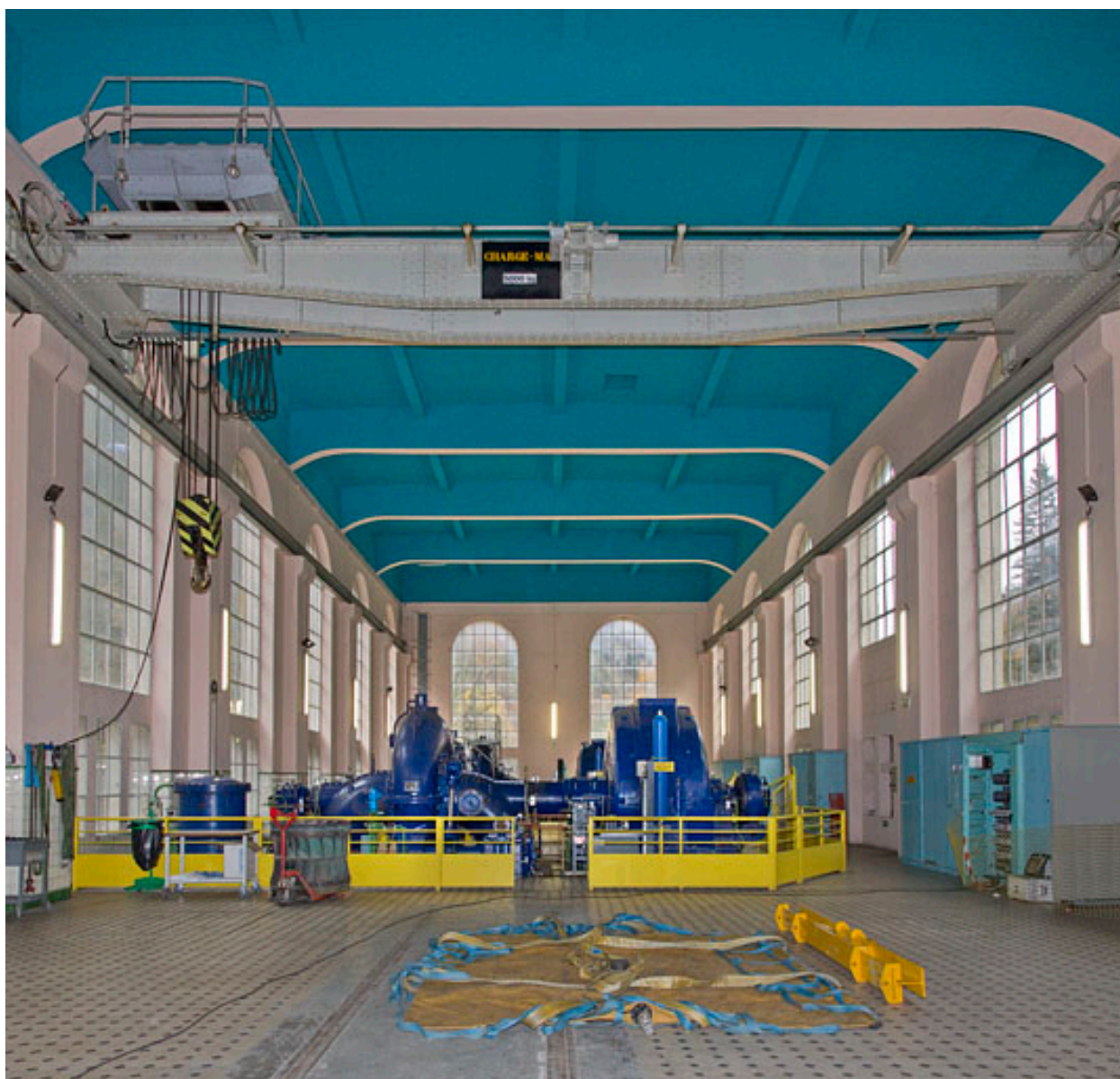
Centrale : intérieur de la salle des machines.
