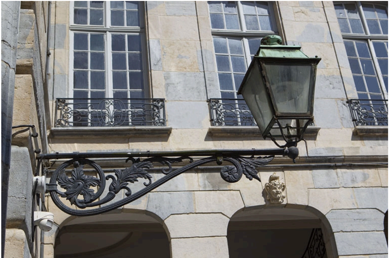
Vue d'ensemble du bec de gaz sur la façade en fond de cour.
