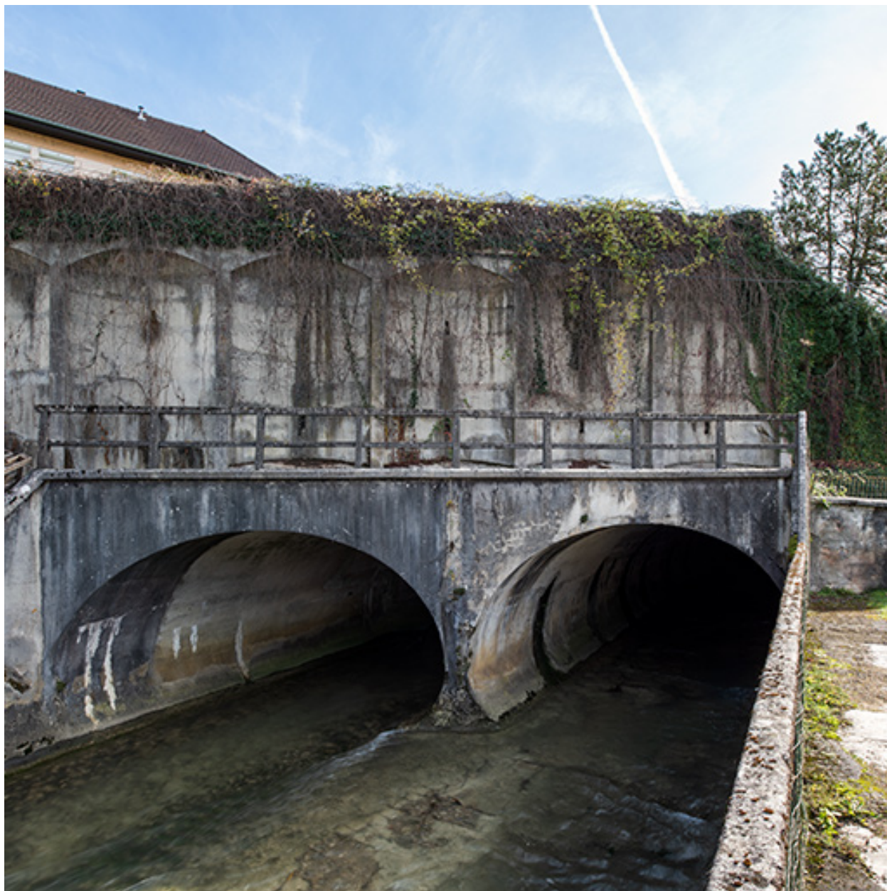
Canalisations de sortie.
