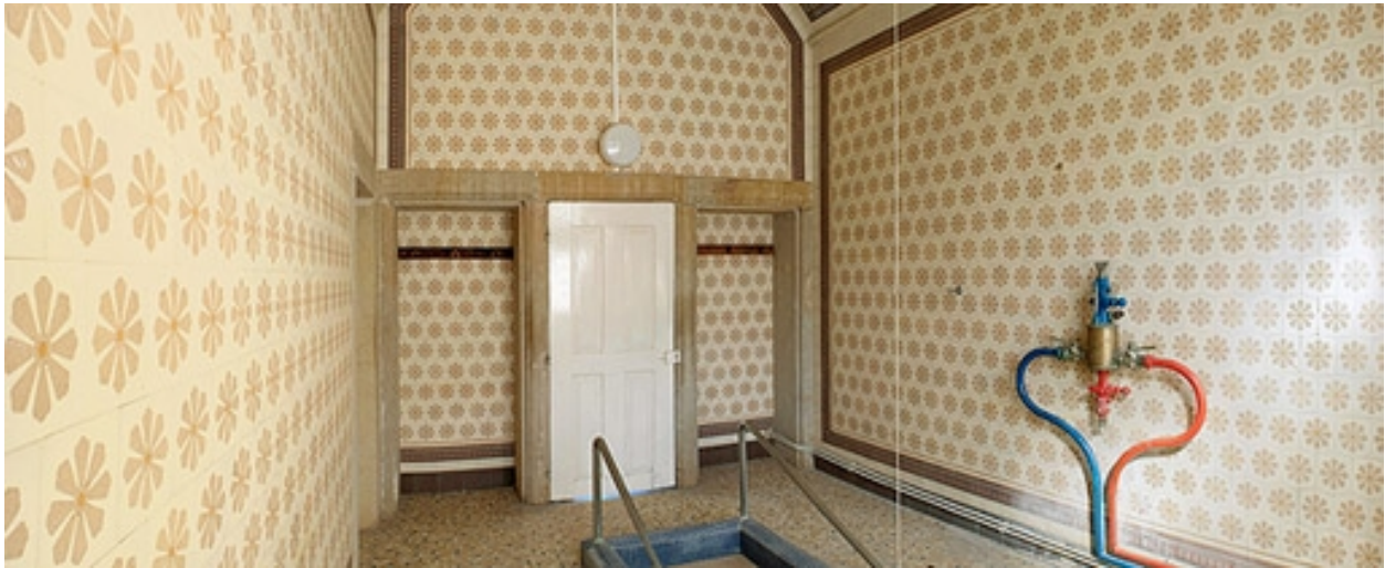
Corps central, salle de bain à droite du couloir du cabinet du médecin, vue vers la porte.
