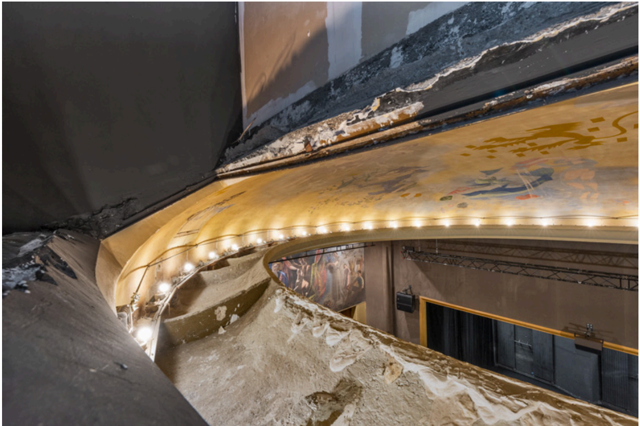
Intrados de la coupole et intérieur de la corniche, depuis la régie.
