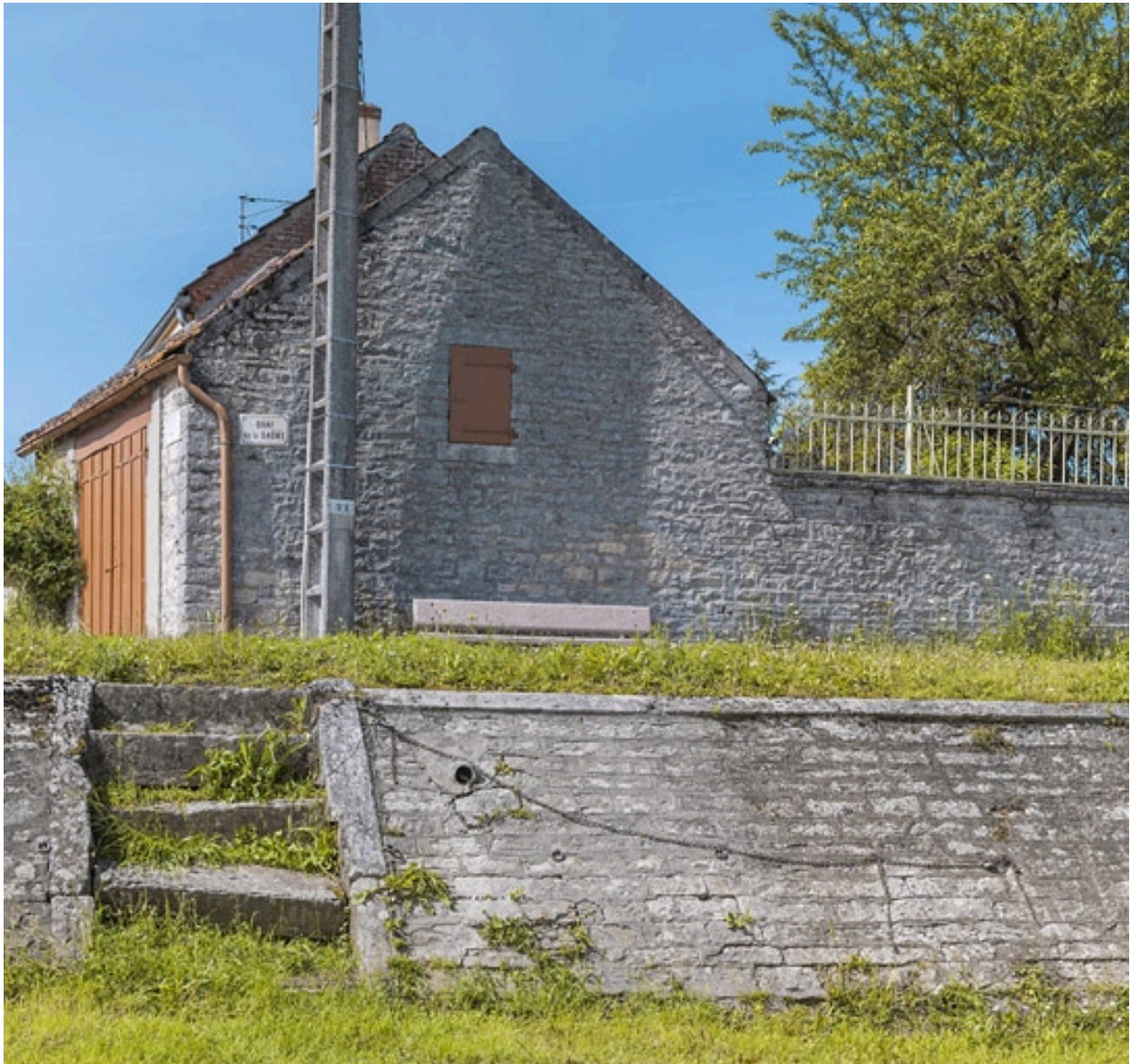
Escalier de sauvetage.
