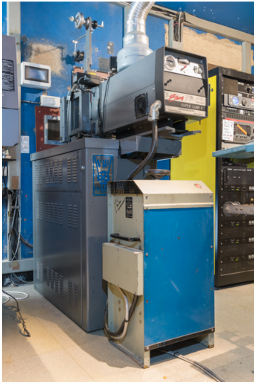
Projecteur Simplex et redresseur Prevost, de trois quarts arrière gauche.
