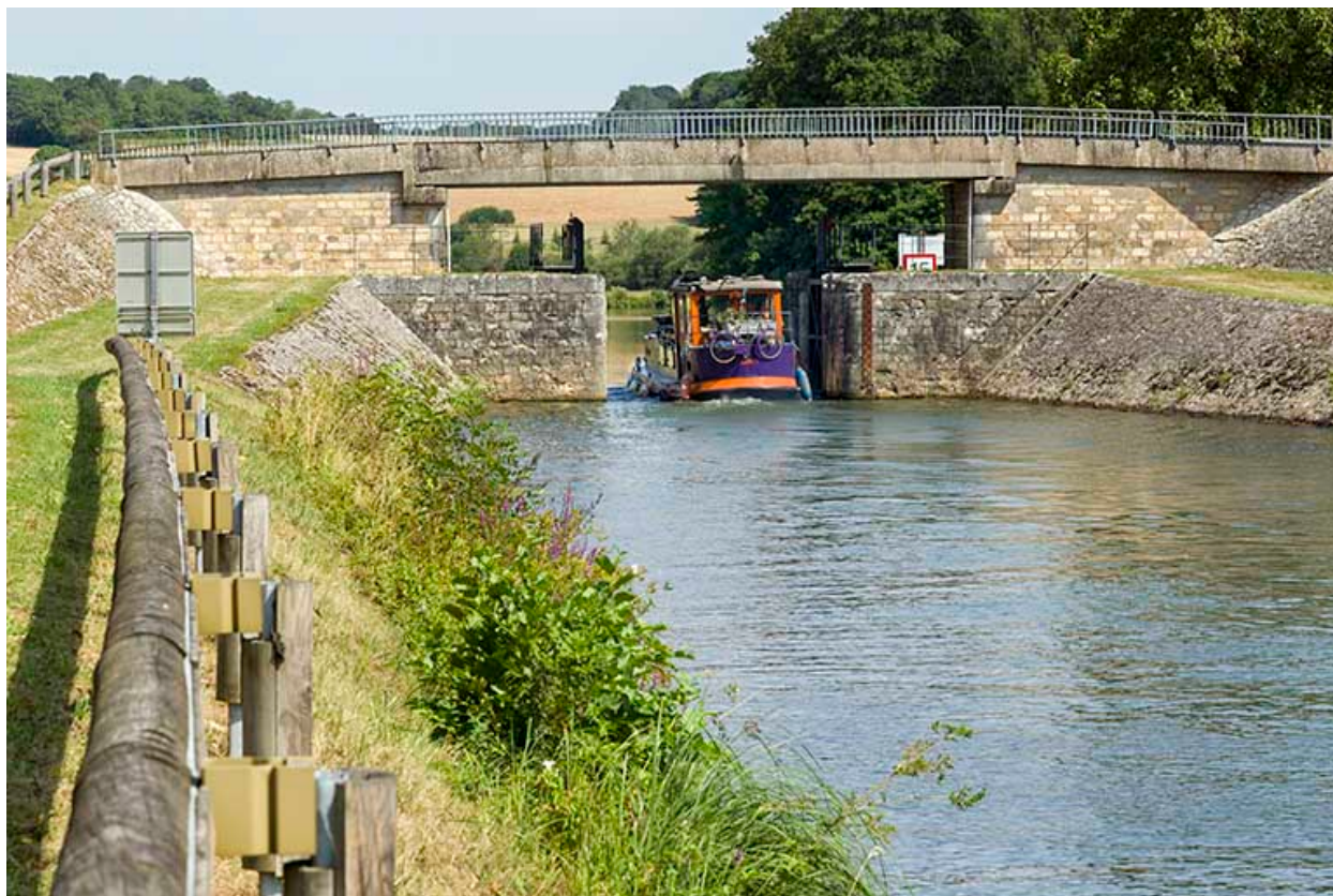
Vue aval de la porte de garde.
