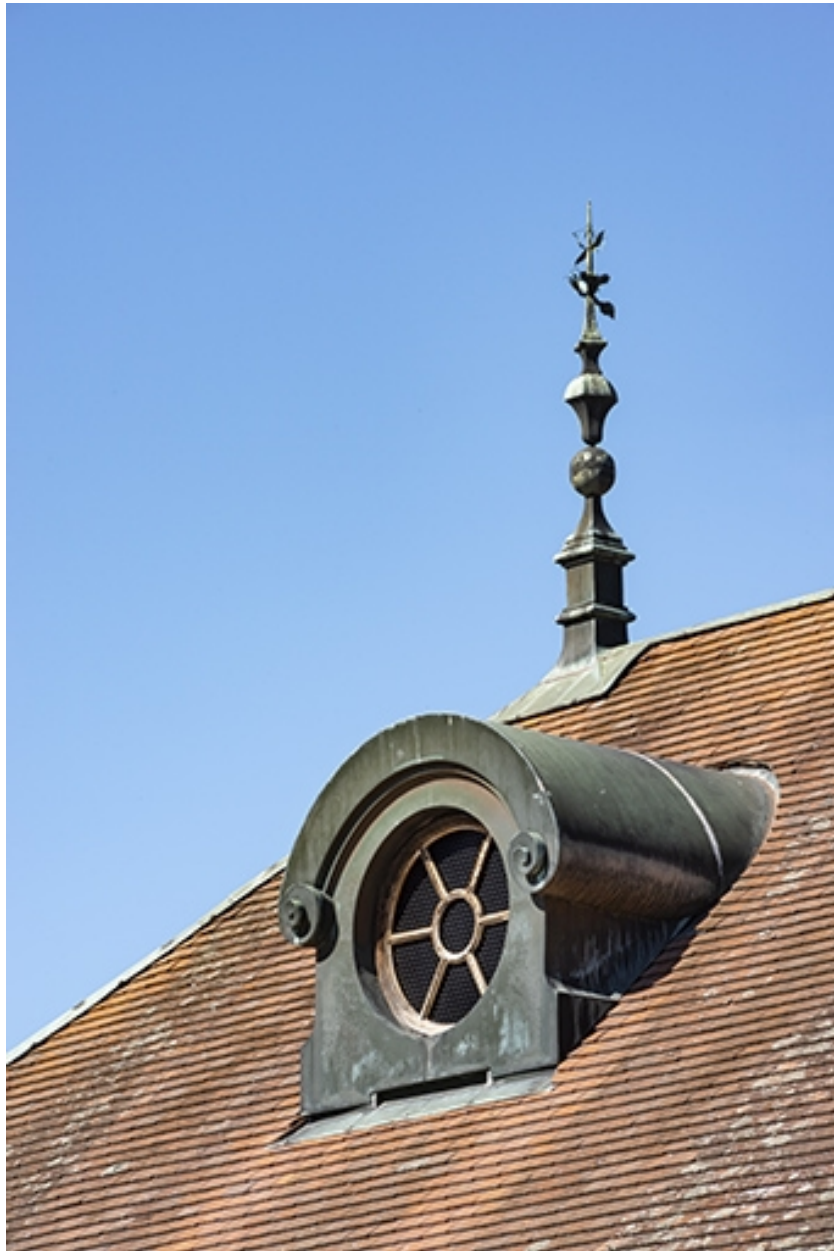
Bâtiment nord dit du Grand Bain, toiture et clocheton, lucarne et épi de faitage.
