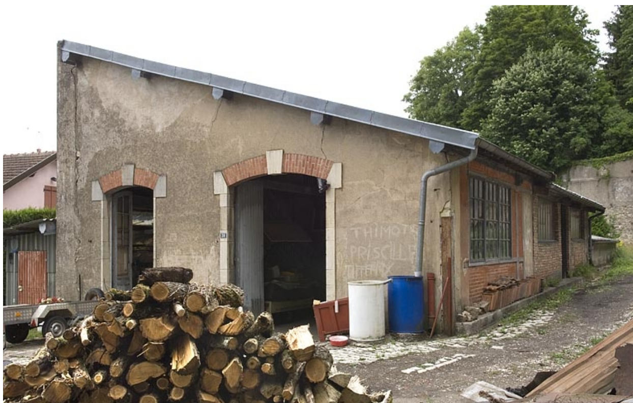
Vestige d'un atelier incendié.
