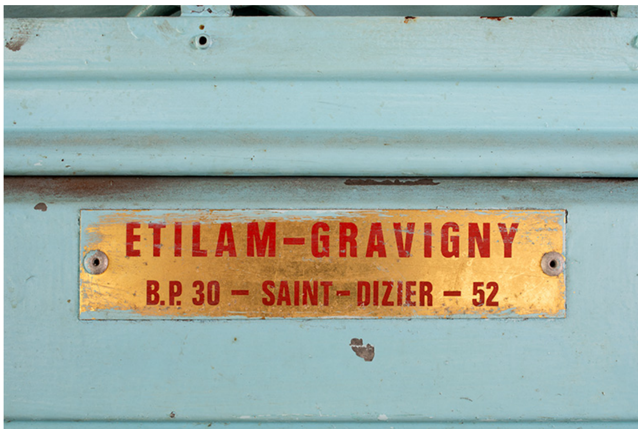
Plaque du fabriquant de la grille : ETILAM-GRAVIGNY à Saint-Dizier.
