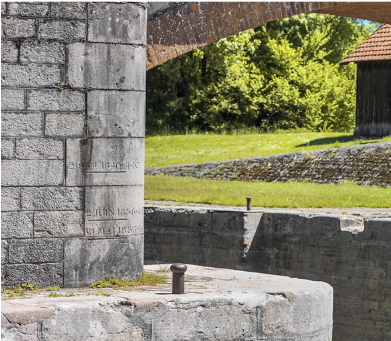
Détail de l'échelle de crue.
