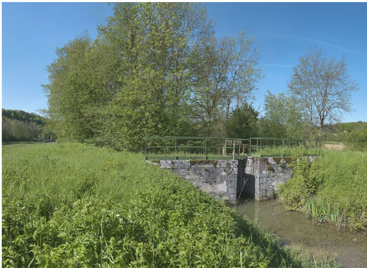
Vanne de prise d'eau.
