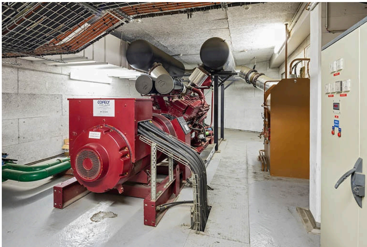
Groupe électrogène de secours.
