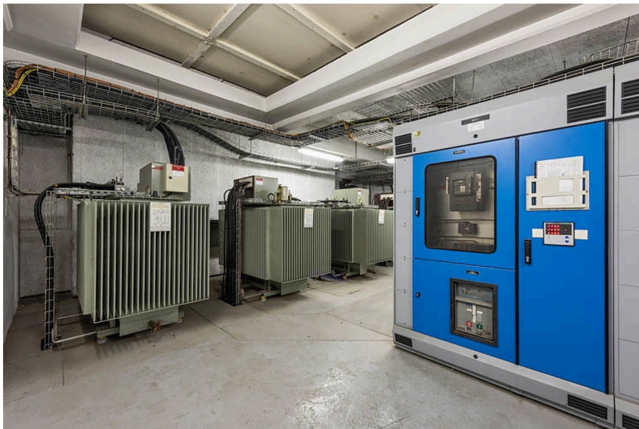
Salle de l'alimentation électrique.
