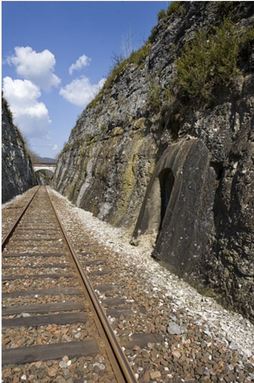
Vue d'ensemble de la tranchée, depuis le côté La Cluse (sud). A droite le cinquième abri.
