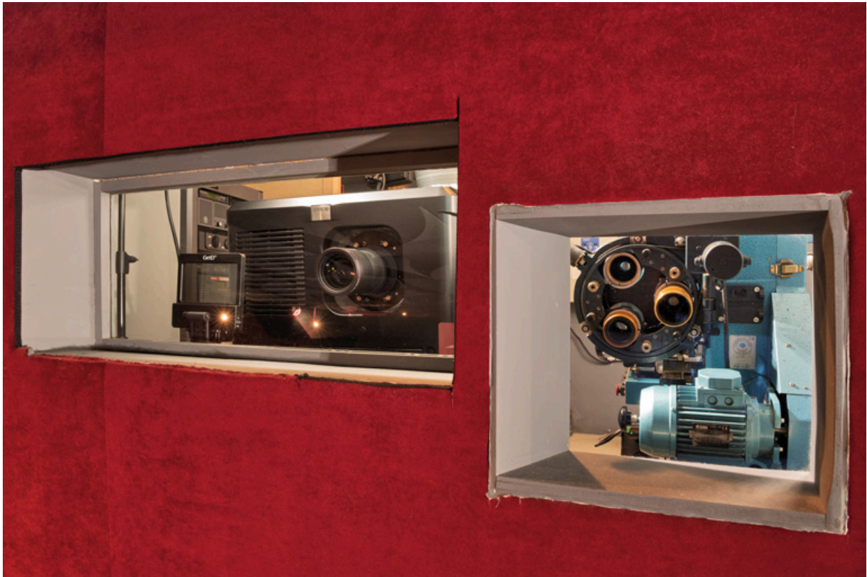
Salle 1 : fenêtres de projection. Projecteurs numérique Barco (à gauche) et argentique Cinemeccanica (à droite).
