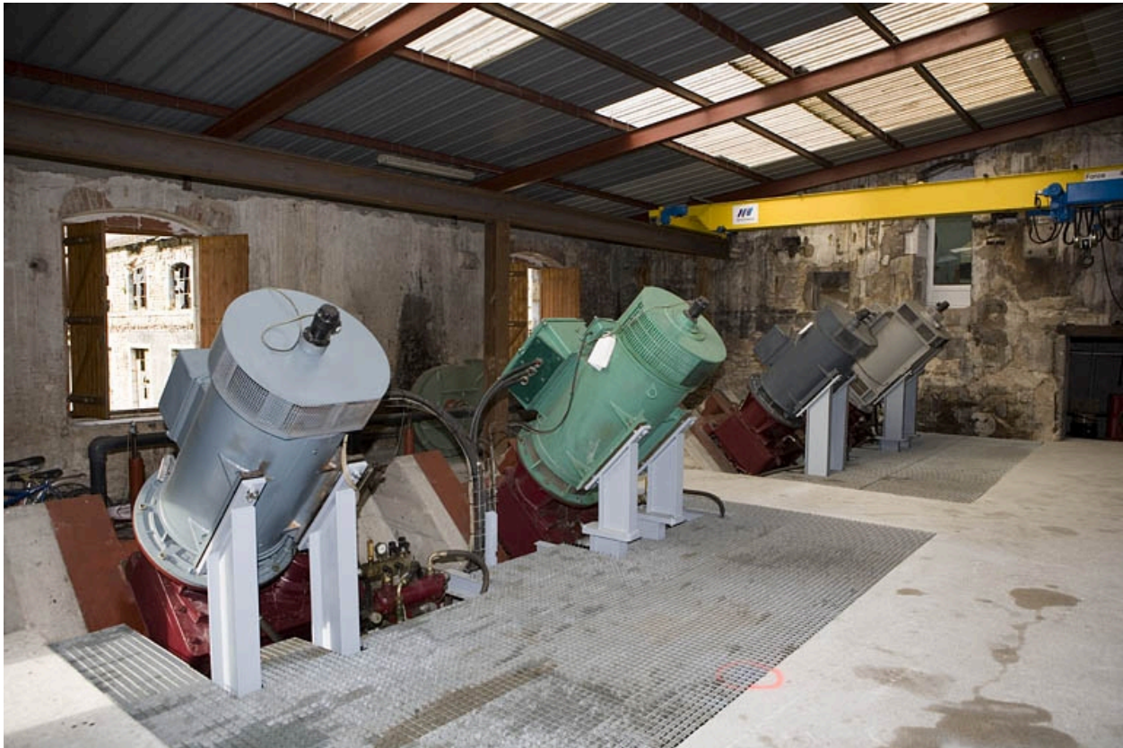
Bâtiment d'eau. Les turbines modernes.
