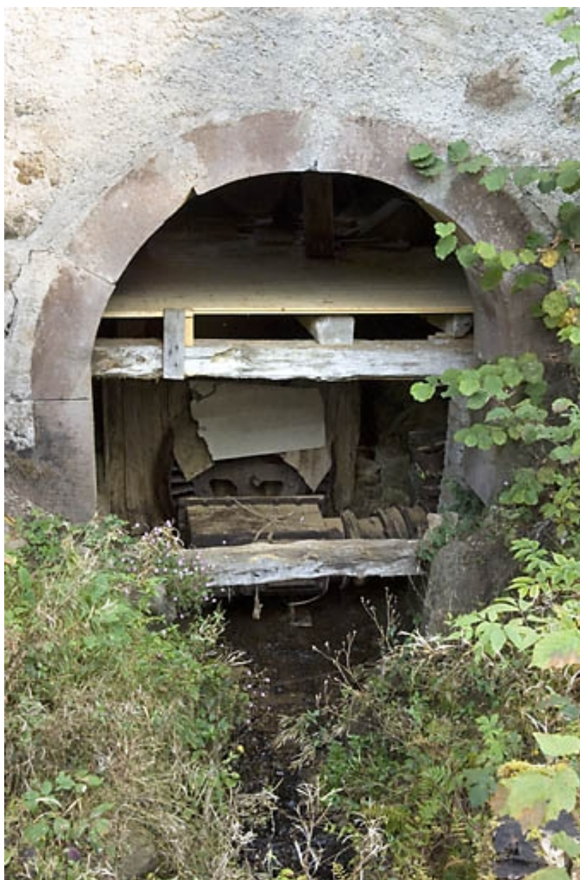
Ouverture cintrée et turbine Wiedeman Frères.
