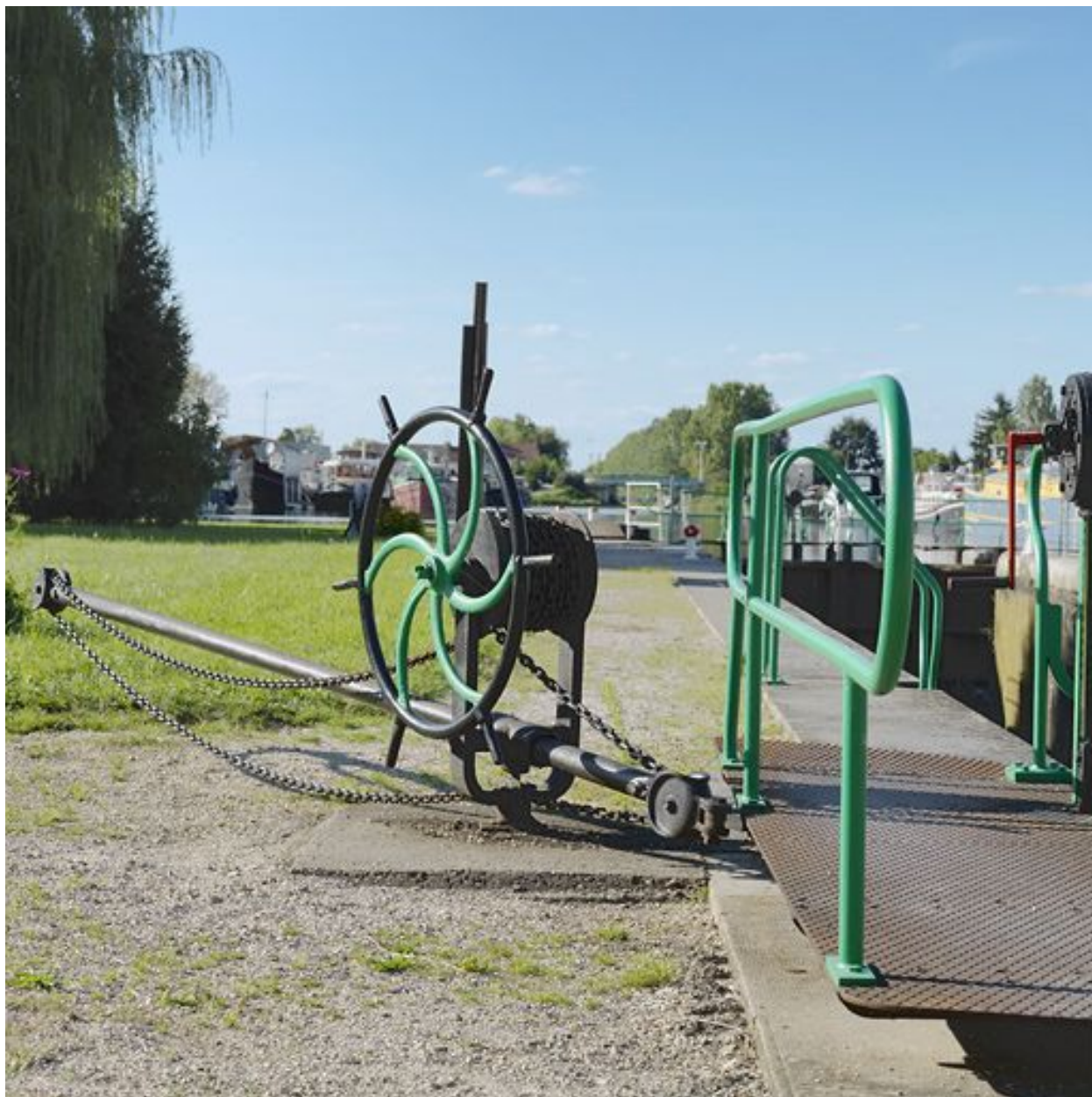
Détail du mécanisme des portes du sas.
