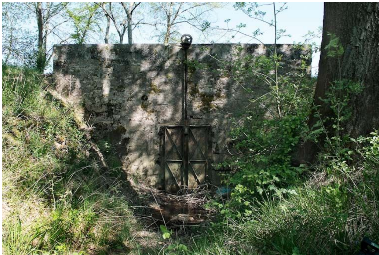
Vanne de l'aqueduc.
