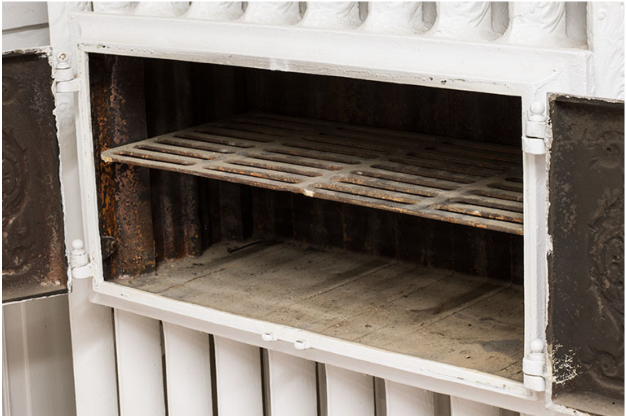
Bâtiment de l'administration, 1er étage : radiateur à chauffe-plat, détail du chauffe-plat.
