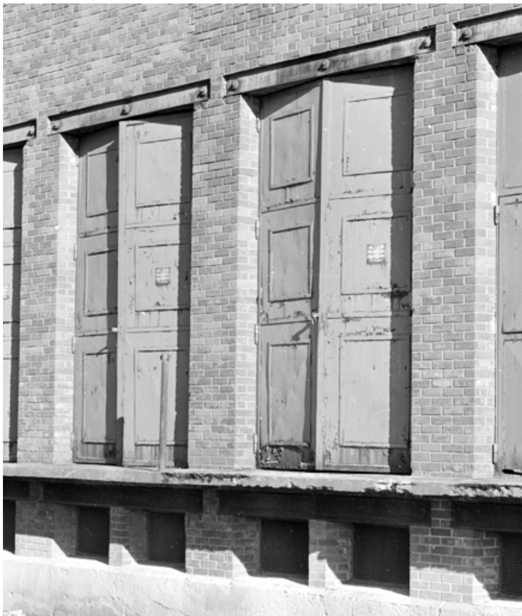
Transformateur : détail des portes métalliques.
