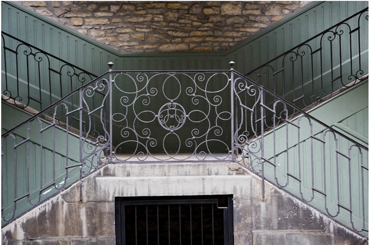
Escalier à cage ouverte à droite de la première cour : détail de la grille en ferronnerie.
