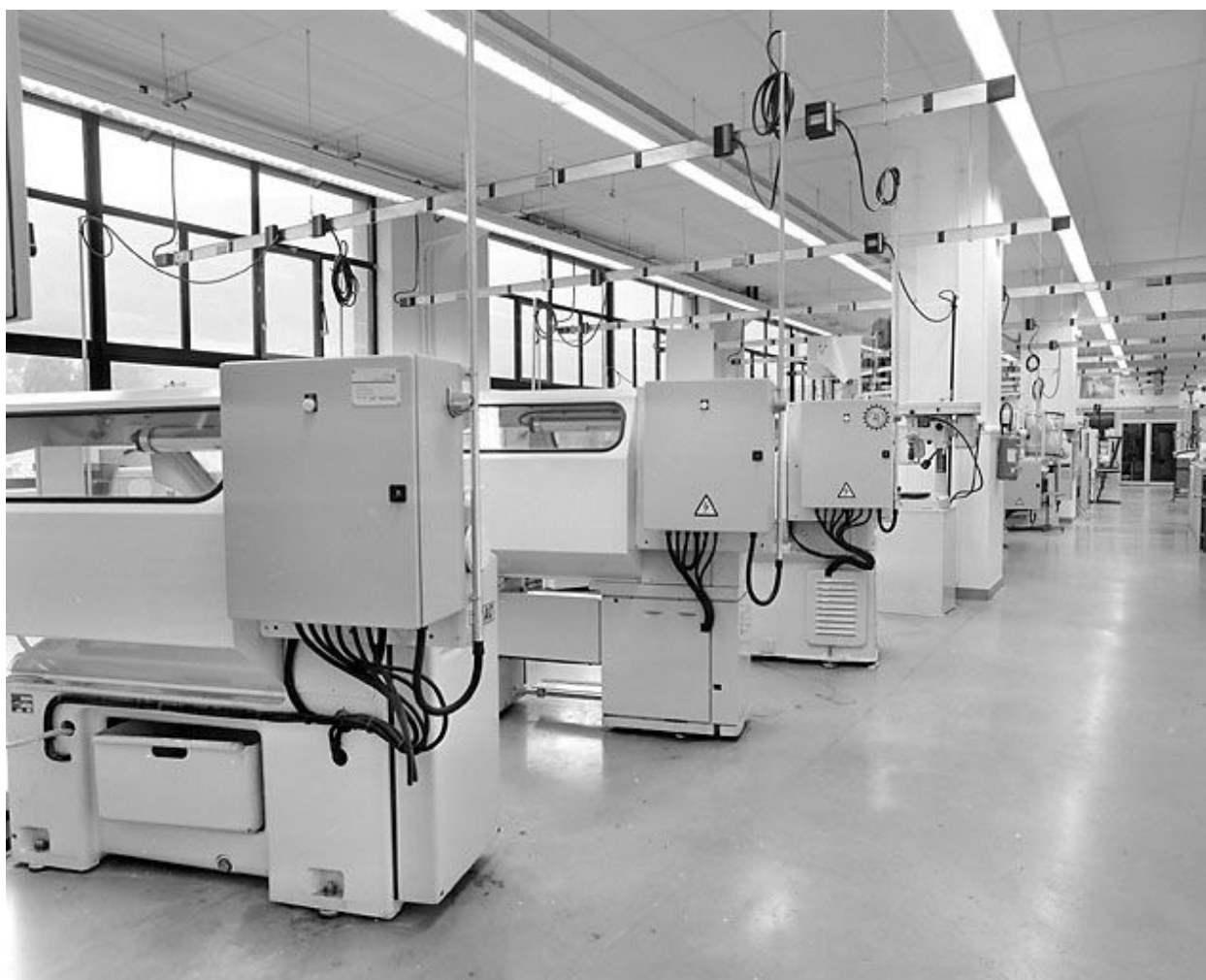
Bâtiment B, atelier de mécanique : vue d'ensemble des tours.
