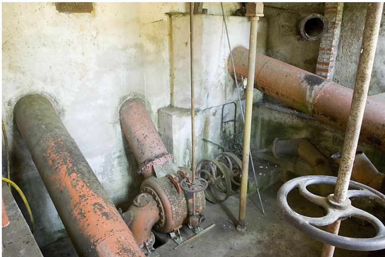
Intérieur du bâtiment d'eau.
