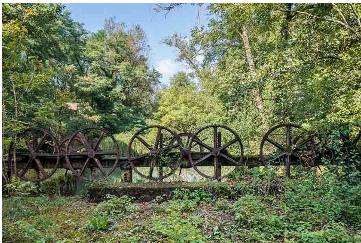
Mécanisme de levage du vannage (canal d'amenée).
