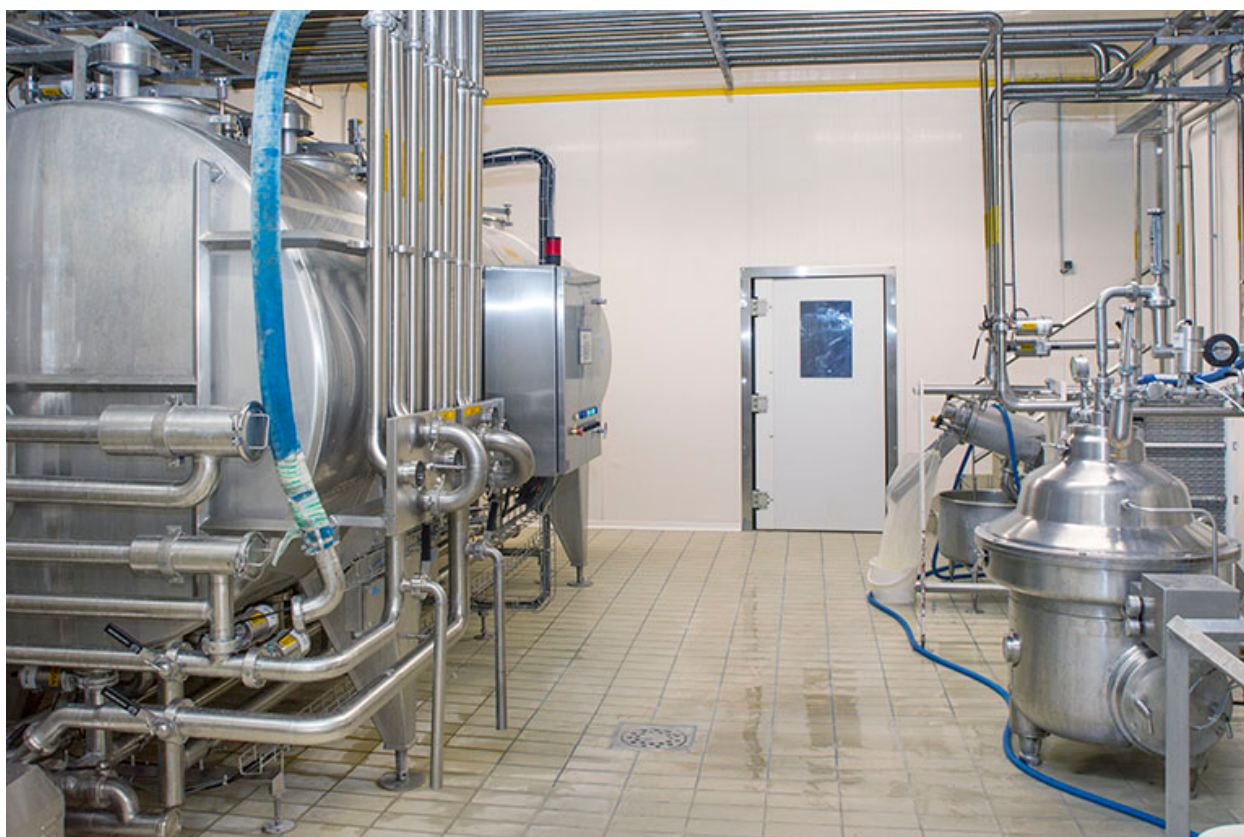
Salle de la station de lavage CIP.
