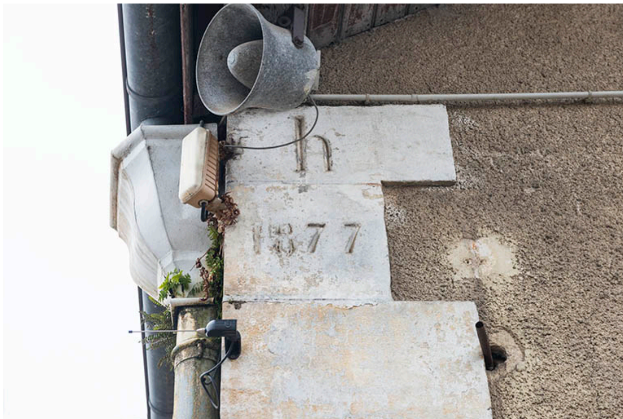
Détail du pignon nord de l'actuel atelier soudure du greta, avec date portée : 1877.
