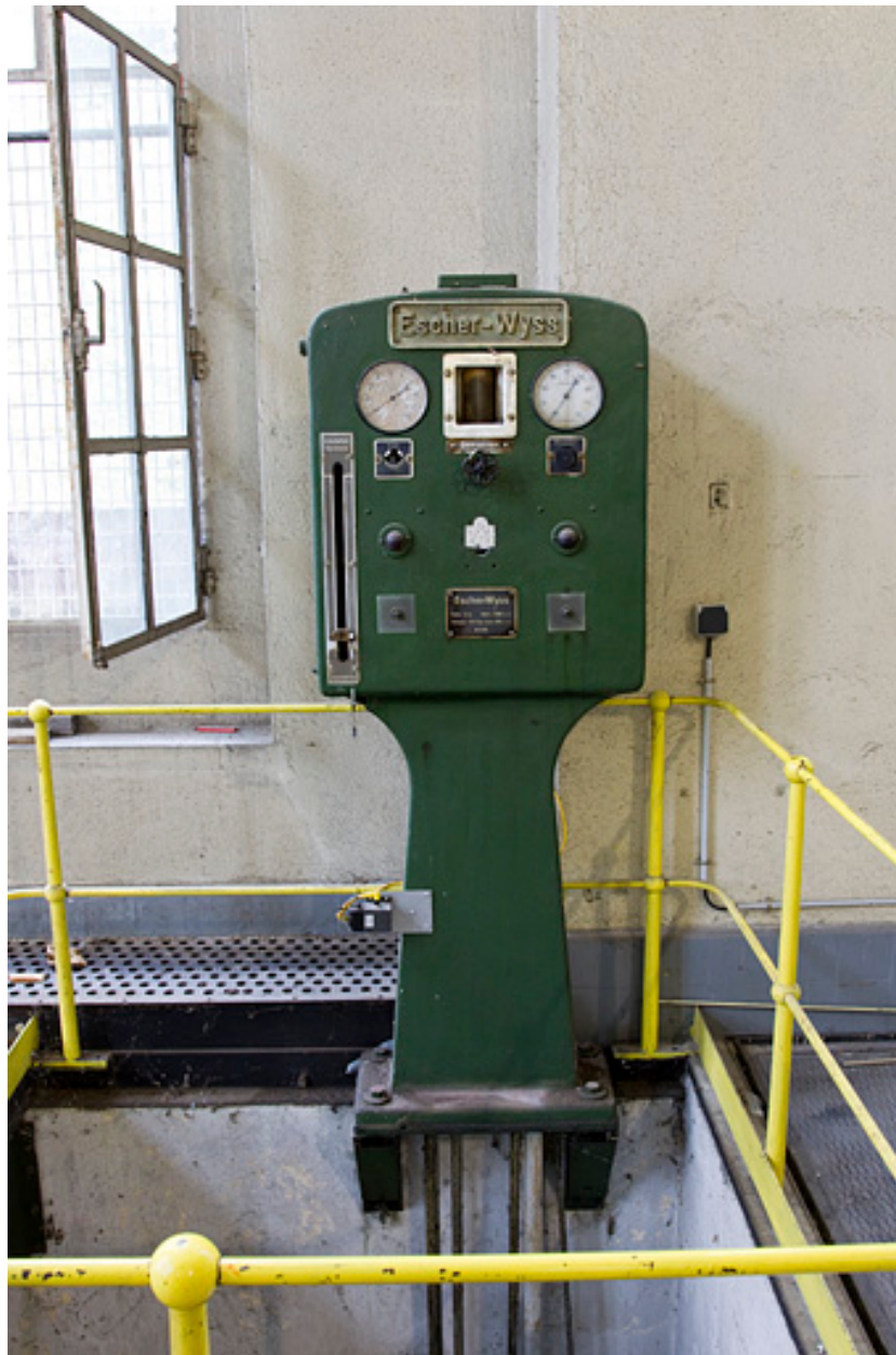
Centrale : commande de la vanne de pied du groupe n° 4.
