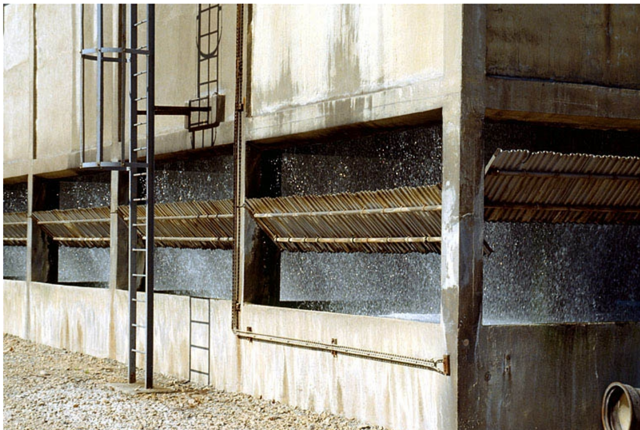
Détail de l'une des tours de réfrigération.
