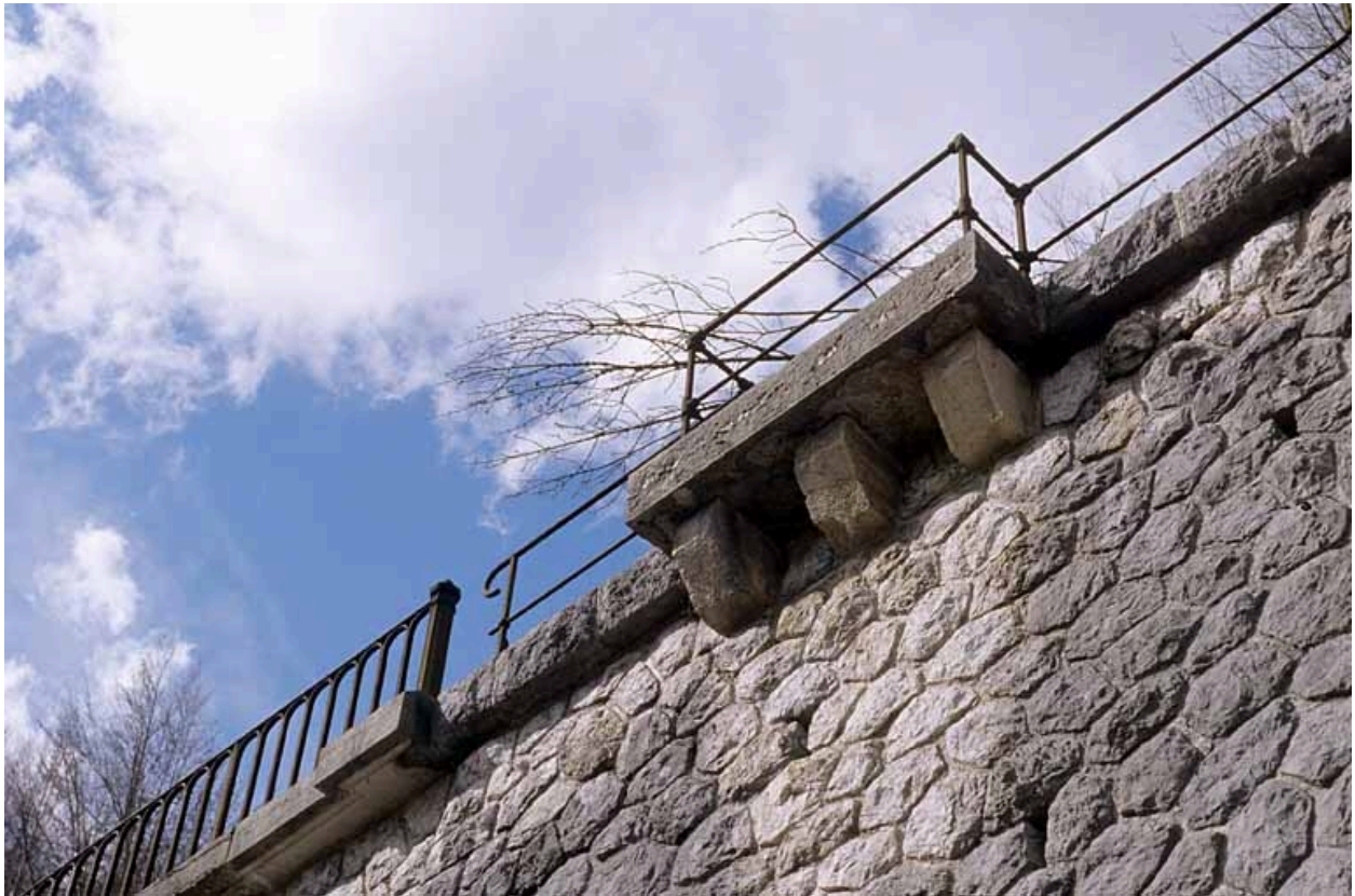
Garde-corps métalliques du mur (à droite) et du viaduc (à gauche), vus depuis la route.
