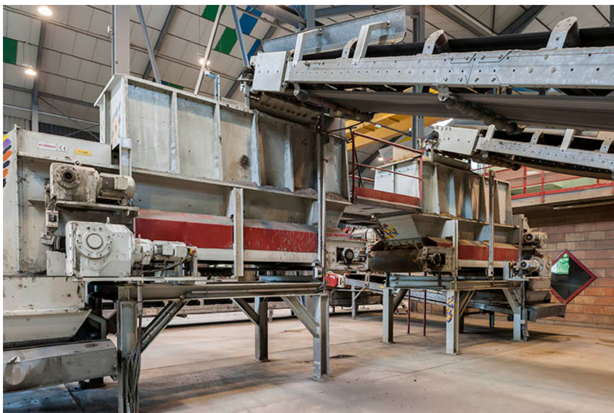
Unité de préparation des terres. Doseurs-tampon.
