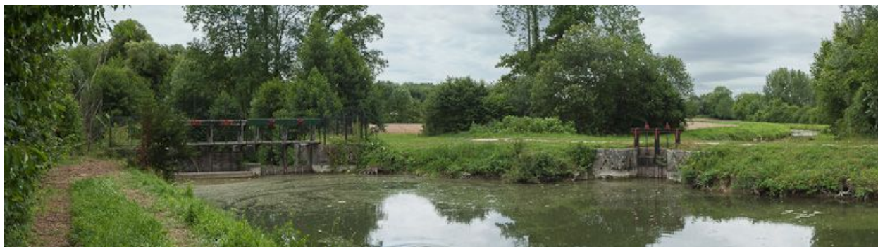
Vue des vannes de prise d'eau.
