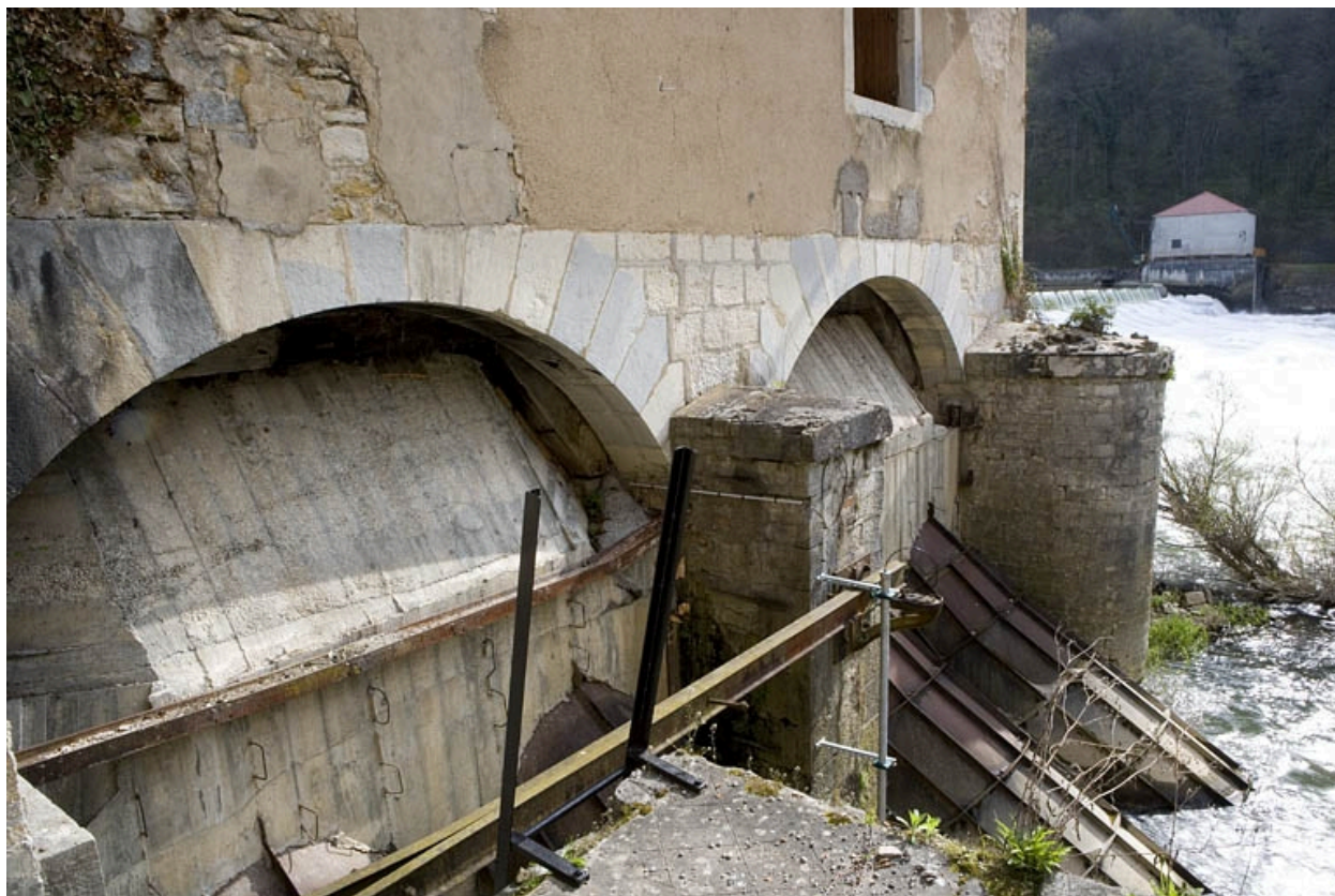
Bâtiment d'eau. Conduites d'évacuation d'eau.
