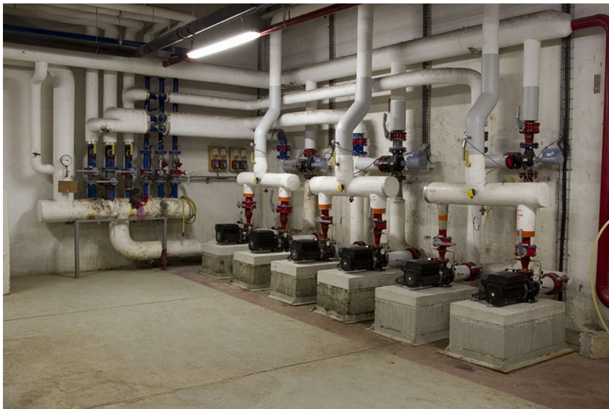
Bâtiment de l'internat ouest, chaufferie : les pompes.
