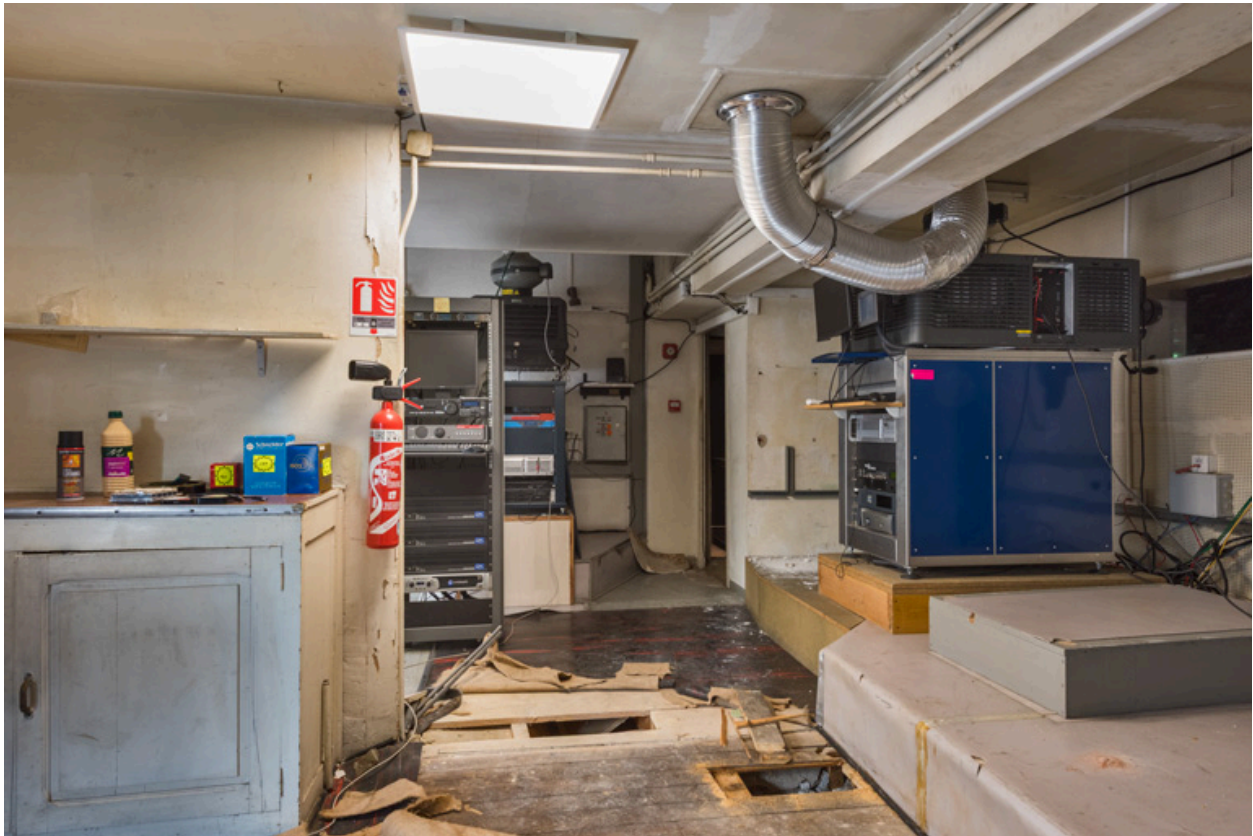
Cabine de projection des salles 1 (à droite) et 2 (au fond).
