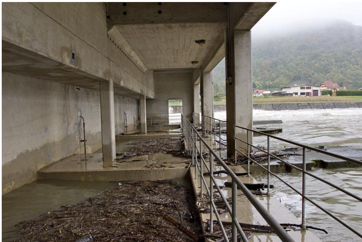
Partie inférieure de la salle des commandes.
