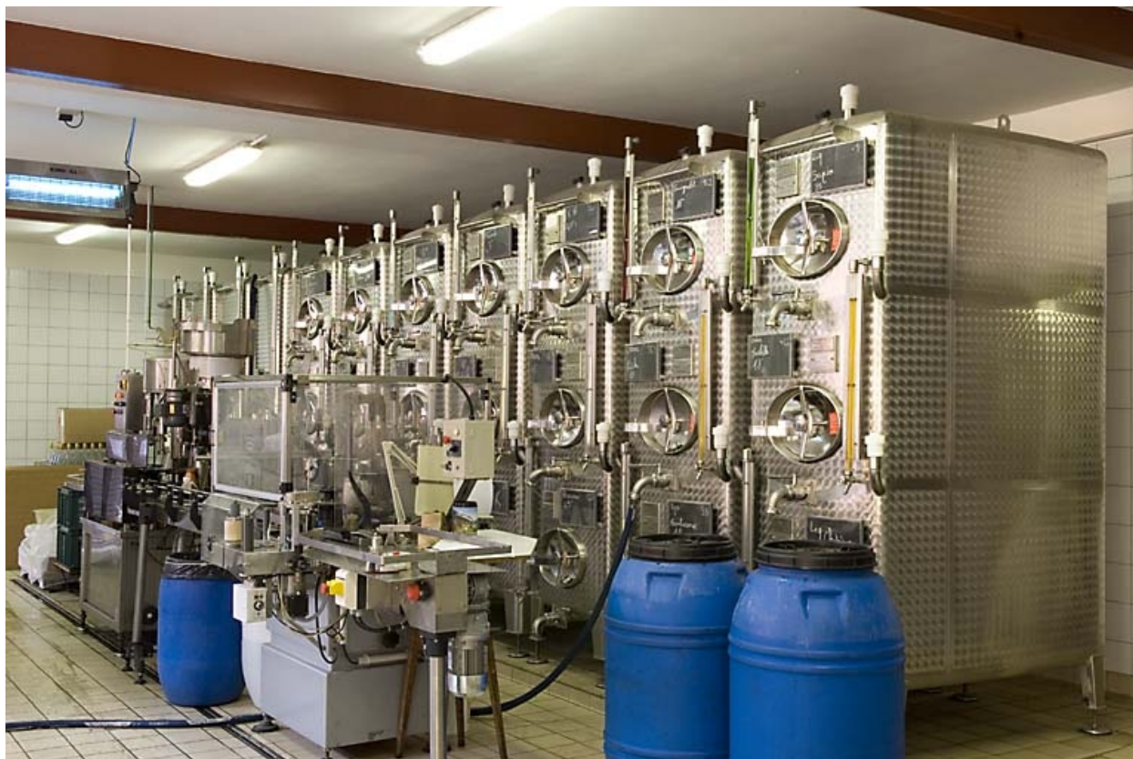
Chai. Batterie de cuves.
