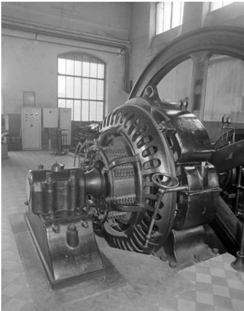
Salle des machines (10) : dynamo Schneider et Cie.
