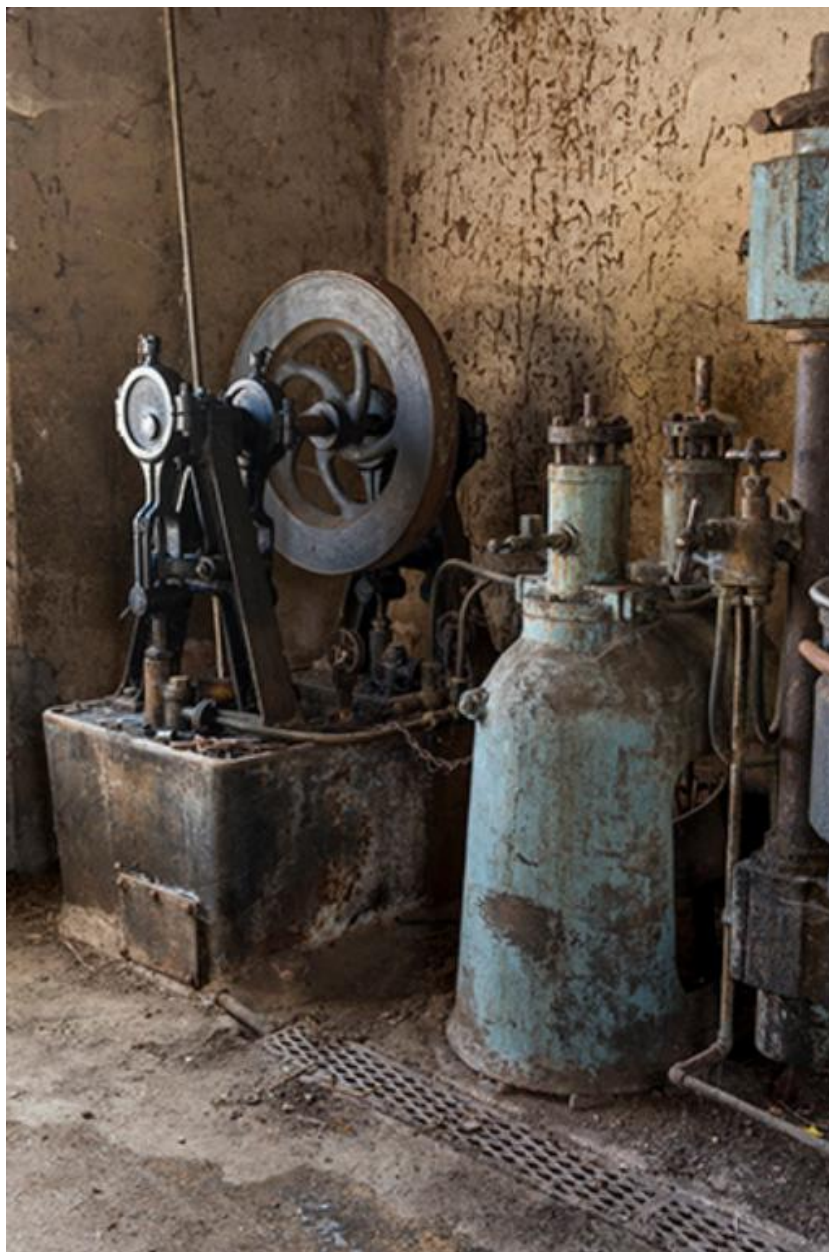
Machines du rez-de-chaussée: pompe hydraulique et régulateur
