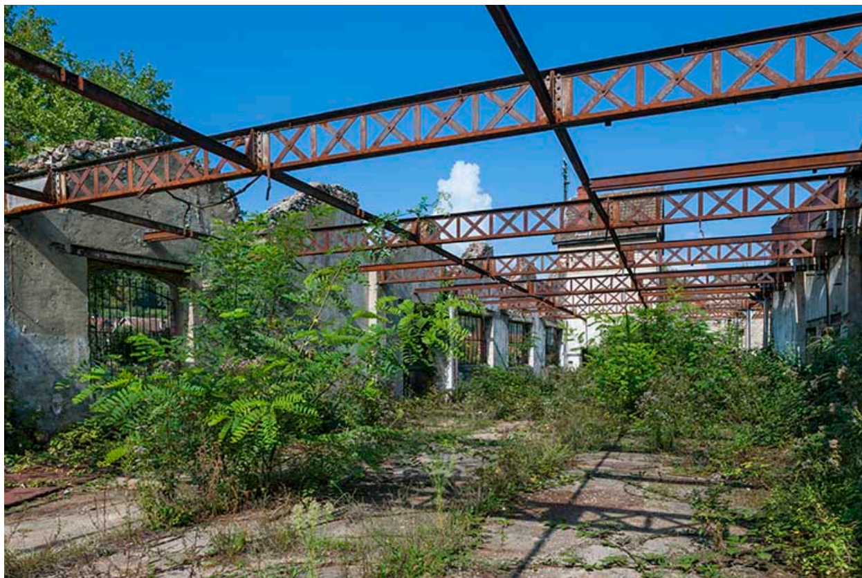
Vue Intérieure de l'atelier de fabrication.
