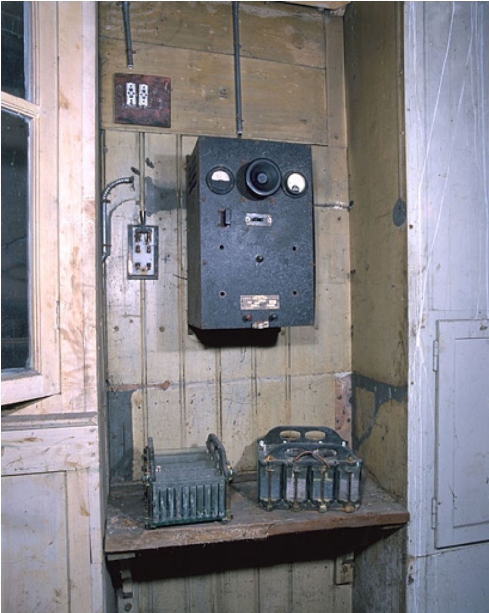
Chargeur de batterie Oxymétal Westinghouse : vue d'ensemble du chargeur et des batteries.
