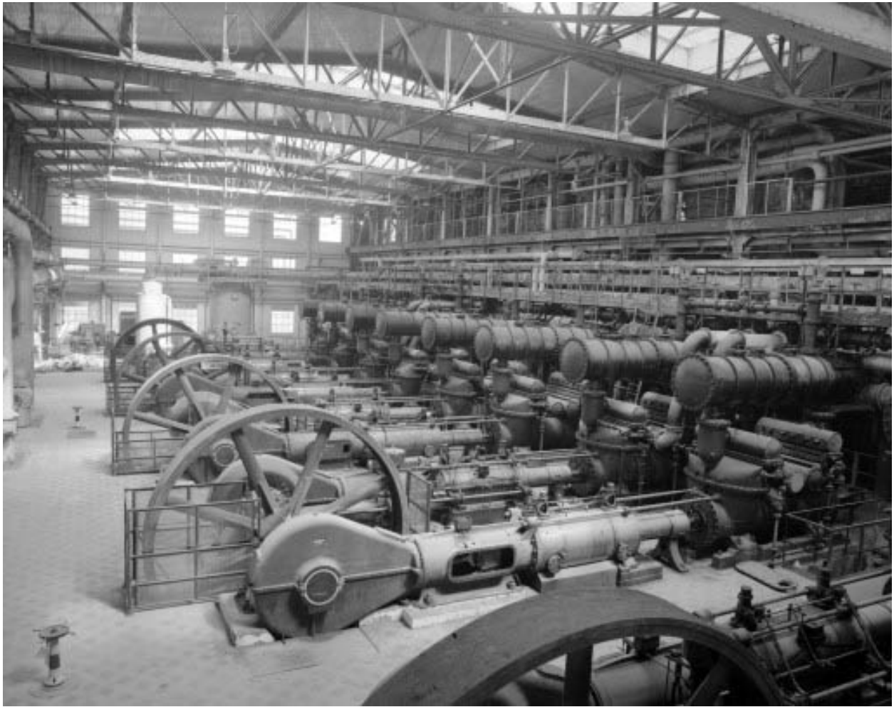
Soudière, salle des machines : vue d'ensemble des pompes à gaz (vue de trois quarts).
