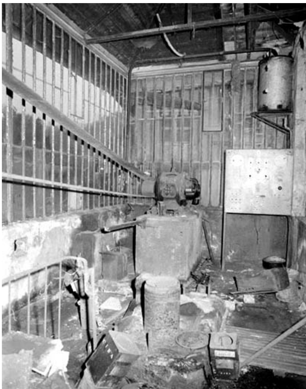
Moteur électrique Patay.
